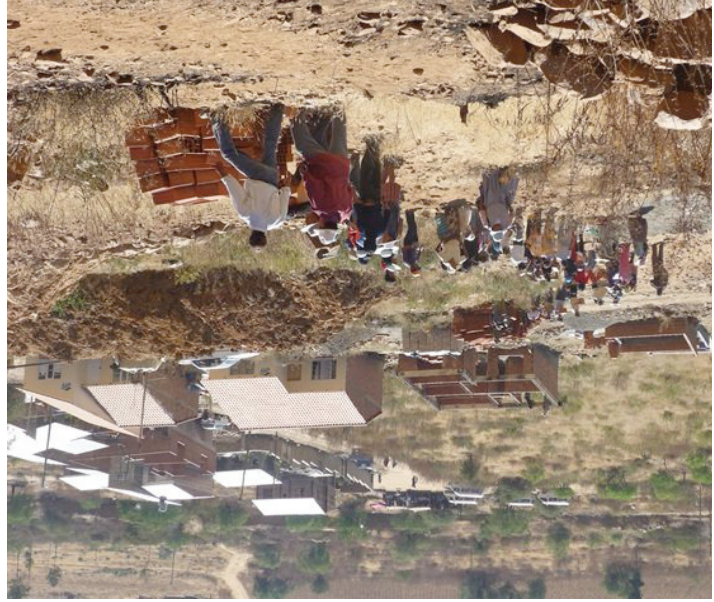
Habitantes formando una línea para transportar ladrillos a lo alto de una colina para construir una casa en la comunidad María Auxiliadora en Cochabamba.
